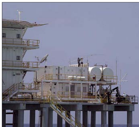
Antennenmontage auf der Modul-Plattform
